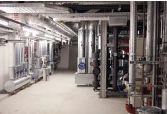
Beeindruckende Technik in den Kellerräumen unterm Notfallzentrum. Ohne sie geht hier gar nichts
