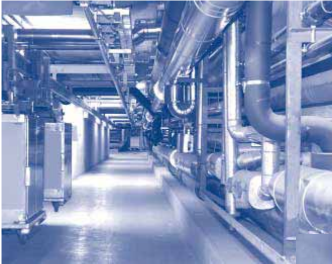
DIE AWT-ANLAGE VERSORGT UNBEMERKT DAS GESAMTE KLINIKUM MIT UNTERSCHIEDLICHSTEN GÜTERN
