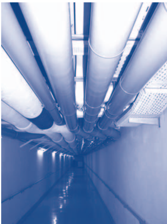
IN EINEM VERZWEIGTEN NETZ AUS INSGESAMT NEUN KILOMETER LANGEN ROHREN TRANSPORTIEREN ROHRPOSTBÜCHSEN KLEINGÜTER
